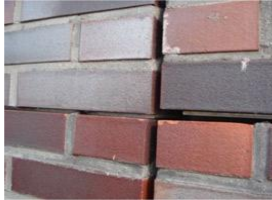
Foto 1: Verzakte metselwerkdragers en weinig ruimte
